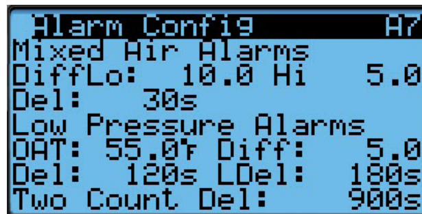
FIGURE 2.6 Réglage des valeurs d'alarme d'air recyclé
