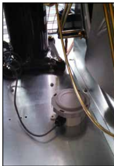
FIGURA 1.3 Instalación del sensor exterior
