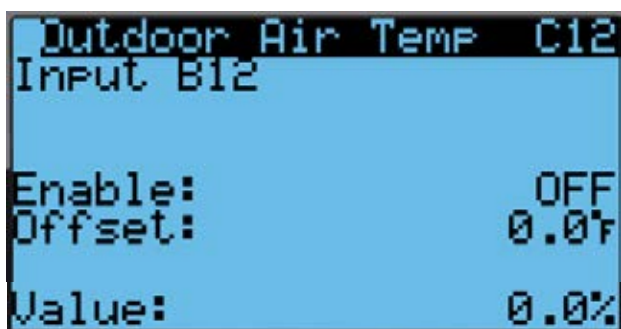
FIGURA 44 Habilitar/inhabilitar sensor de temperatura del aire exterior
