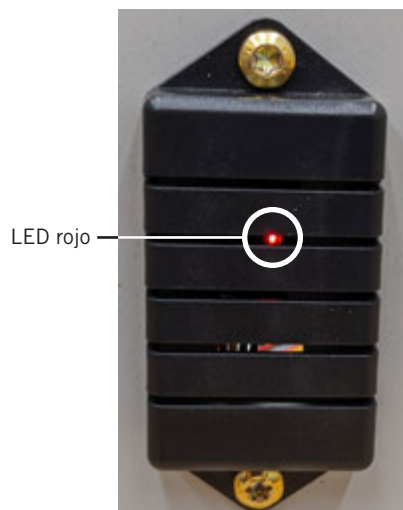
FIGURA 31 Verifique si el LED del sensor está encendido
